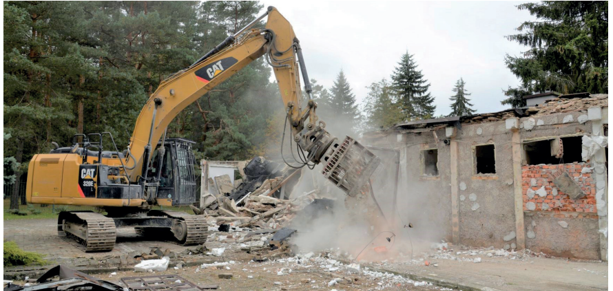
Baraki, w których do tej pory mieściły się biura ZGK, zostały już wyburzone. Wkrótce ława fundamentowa nowego budynku zostanie zalana betonem, fot. C. Puchniarz
