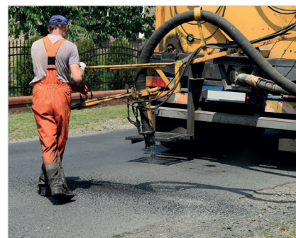
Niestety nie ma takiego sposobu budowania dróg, by po latach eksploatacji nie wymagały one naprawy, fot. Archiwum UMIG
