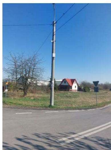
Instalacja monitoringu miejskiego - sołectwo Dębówka
